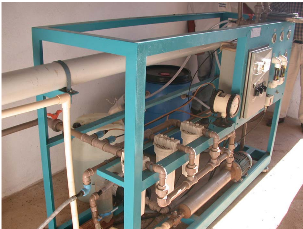
Dessalinizador por osmose reversa
